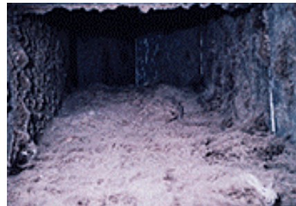
Kanal in Benutzung (es kann passieren, dass der Schimmel den Kanal fast ganz verstopft)
